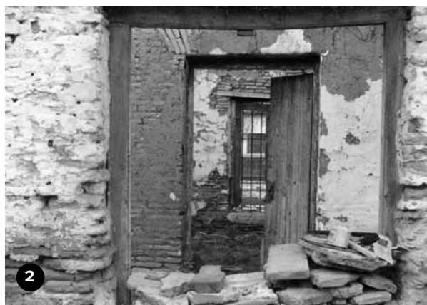
Figuras 3.1-2. Contrafrente de la casa de los Ameghino de la calle Las Heras 466 mostrando el estado precario en que se encontraba en 1989 / Back view of the Ameghino’s house located at Las Heras 466, showing its precarious condition in 1989.
